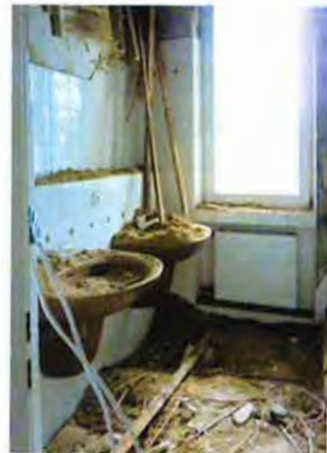
In dramatischem Zustand präsentierte sich das Innere nach dem Wasserschaden
